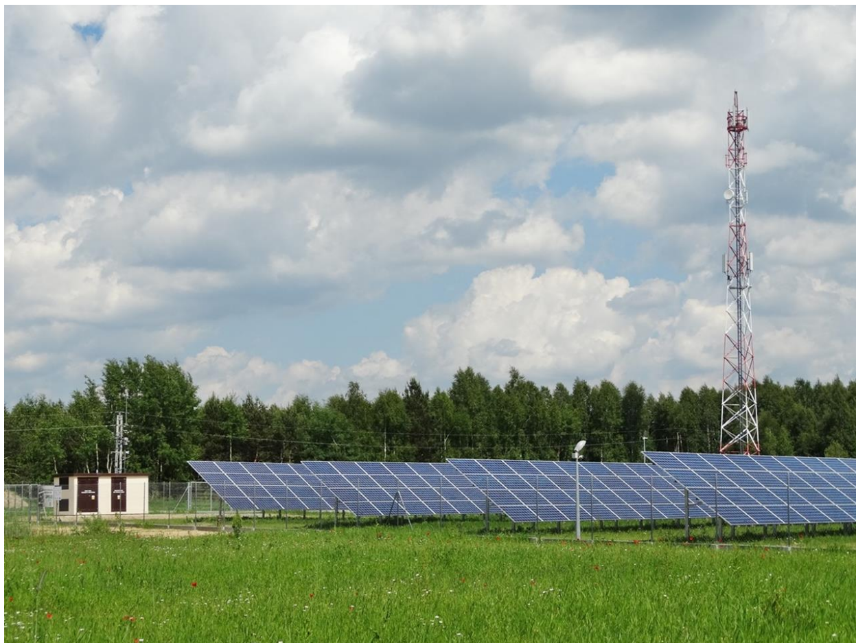
Fot. 1. Elektrownia fotowoltaiczna w Woli Uhruskiej.
